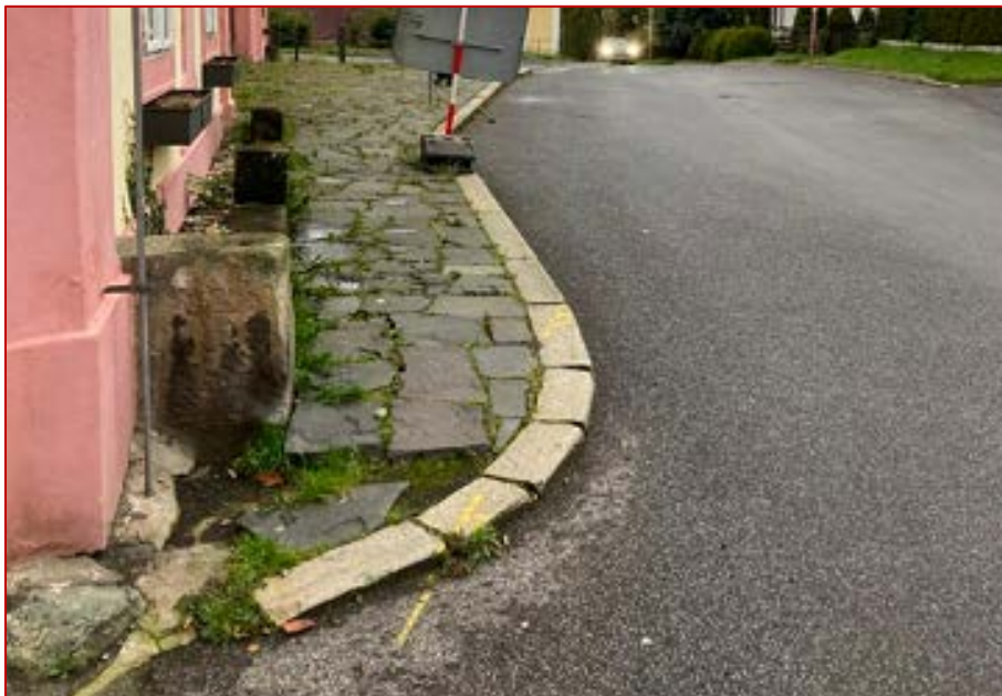
Obrázek 1 Stávající stav komunikací – havarijný stav povrchu
