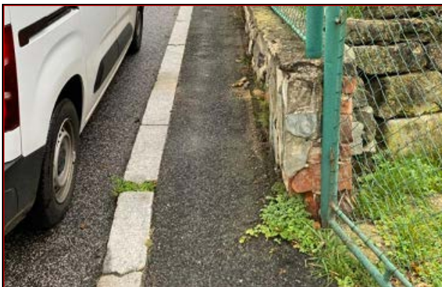
Obrázek 2 Stávající stav komunikací – nedostatečná šířka chodníku 1
