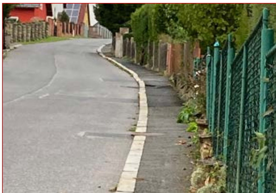
Obrázek 3 Stávající stav komunikací – nedostatečná šířka chodníku 2
