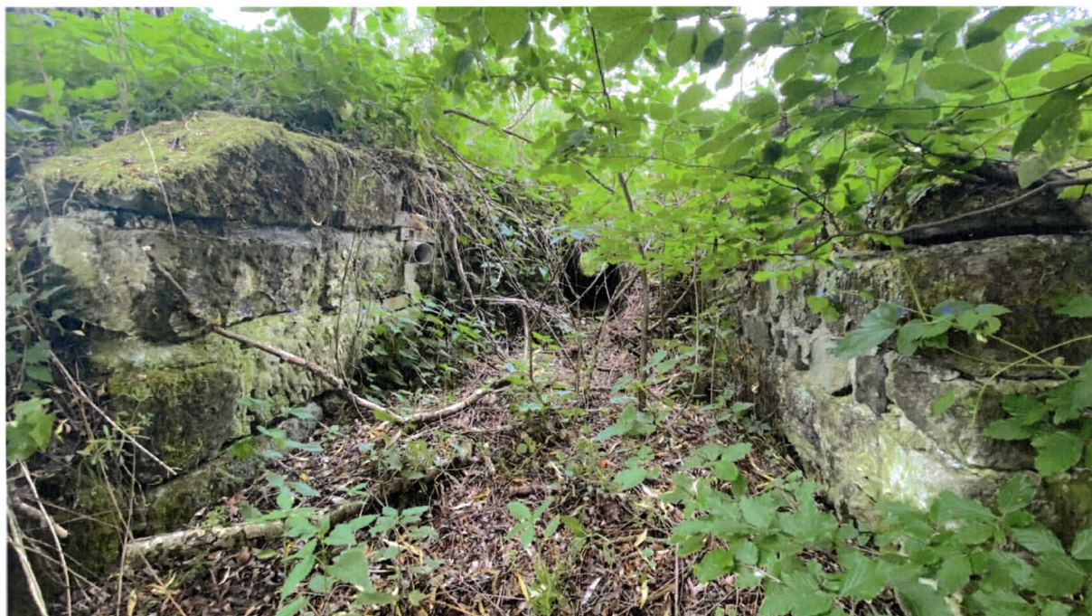
Kamenný odtok bezpečnostního přelivu
